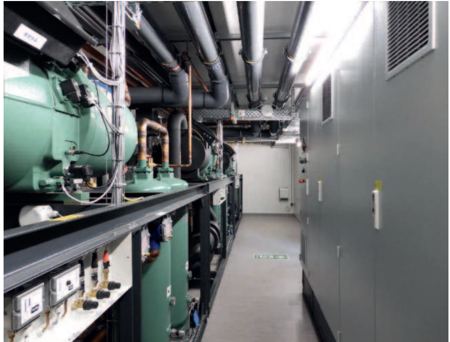
Drei hoch effiziente Kältemaschinen in Split-Bauweise und je 450 kW Leistung – platzsparend im Container verbaut (Bild: © L&R Kältetechnik)
